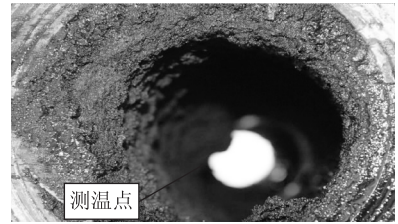
图 4 管道结蜡情况
